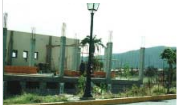
Inicio de las obras de la ampliación externa de la piscina, realizada por la empresa del exconcejal Francisco Robaina. (18-2-2001)
